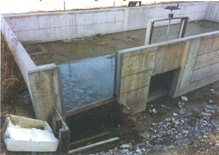
Foto 5. Overløp fra sedimenteringsbassenget
