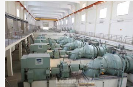
Trạm bơm Yên Sở
